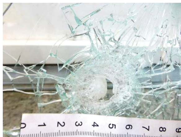
Рис. 2. Повреждение 2 стекла № 1 картечью с расходящимися от краев радиальными и концентрическими трещинами
