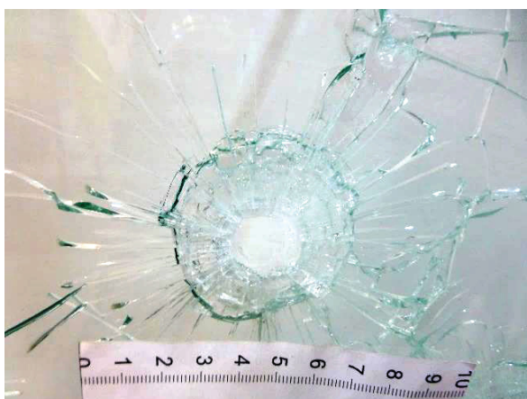
Рис. 5. Повреждение 5 стекла № 1 картечью с расходящимися от краев радиальными и концентрическими трещинами
