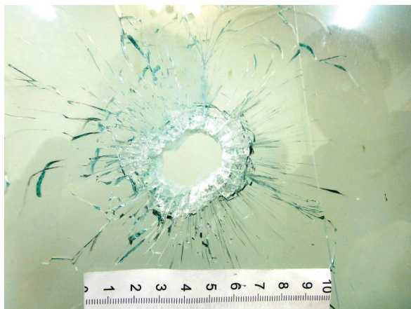
Рис. 6. Сквозное повреждение стекла № 2 с расстояния 10 м пулей с расходящимися от краев радиальными и концентрическими трещинами
